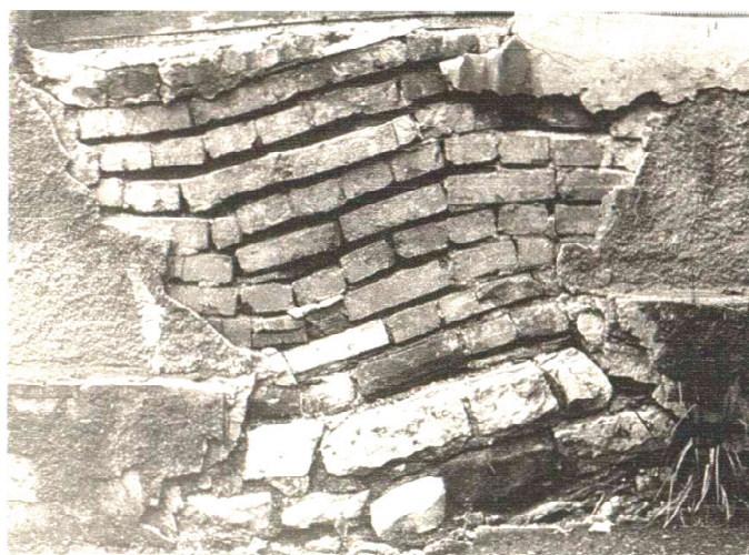
Рисунок 13. Разрушение здания (г. Горловка) в результате аварии коллектора.
