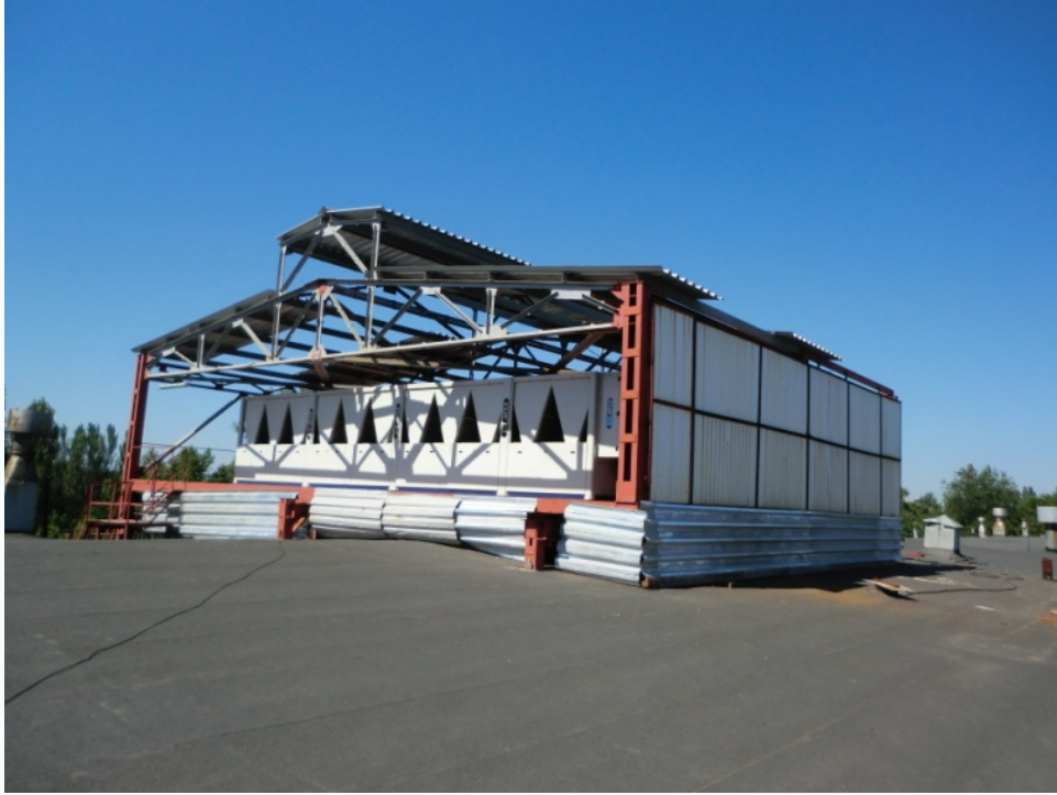
Акустическое укрытие чиллеров на покрытии компрессорной
