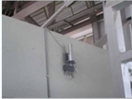
Приборное оборудование системы мониторинга на основных узлах консольных ферм
